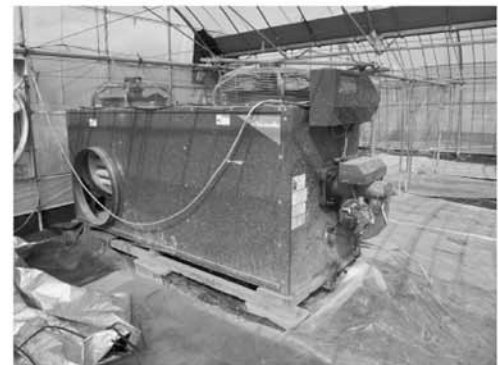
図5 除湿区温室内の温風暖房機(既設)
