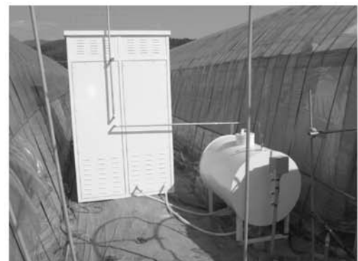
図7 温室外に設置した再生ユニット
