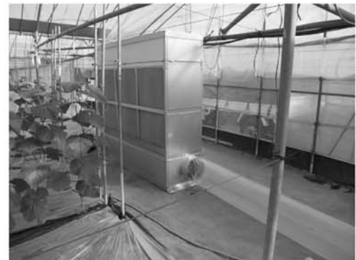
図6 除湿区温室内で稼働中の除湿ユニット
