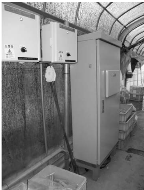
図8 温室外に設置した制御ユニット
