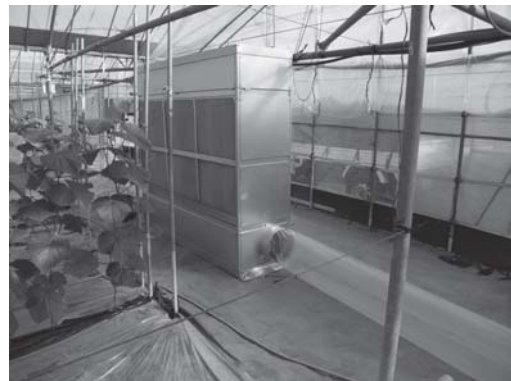
図 1 温室内に設置・稼働中の除湿ユニット
