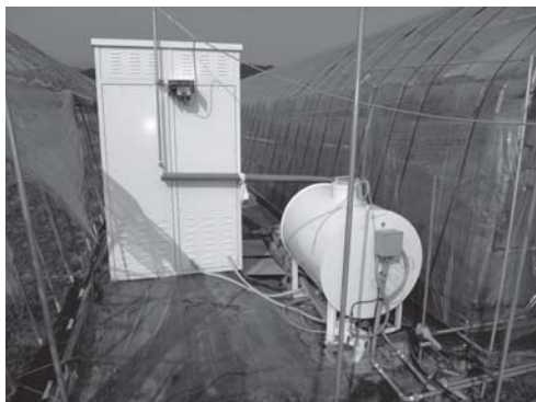
図2 温室外に設置した再生ユニット
