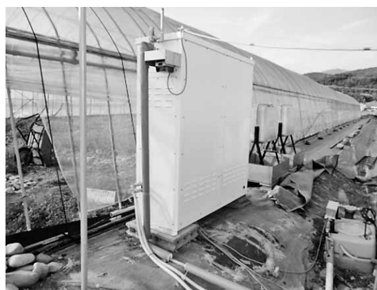
図12 吸湿液加熱再生ユニット
