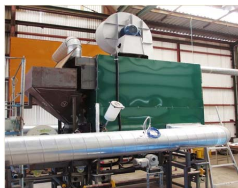
図 4 試作ボイラーの外観写真
