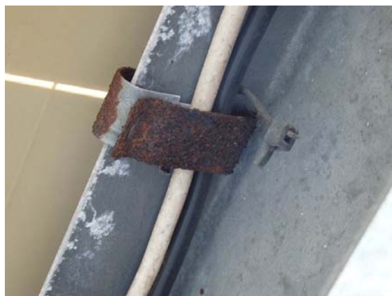
図 7 ケーブル支持金具の発錆状況
