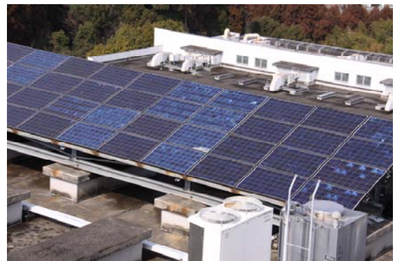
図2 当センター屋上に設置した太陽光発電設備の外観
