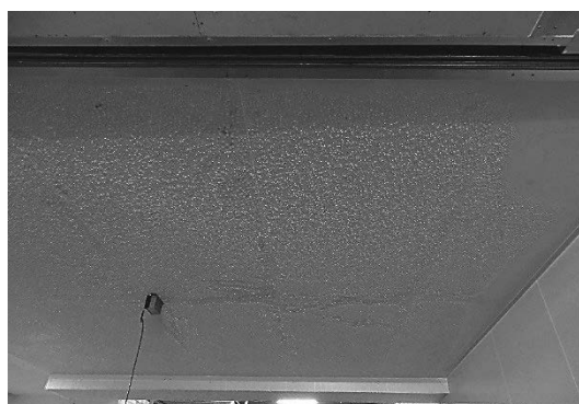
図3 実験区の結露状況
